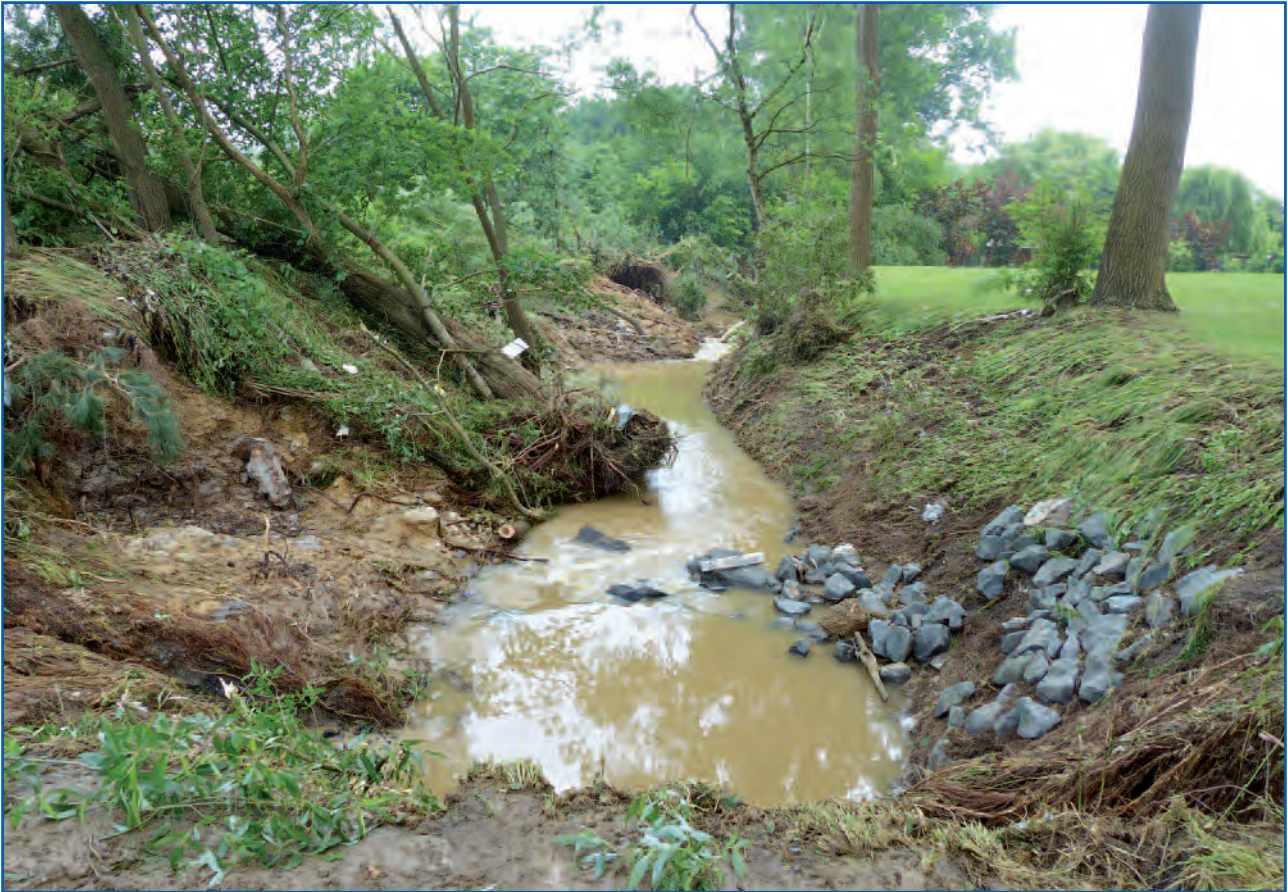
Schäden am Leimersdorfer Bach, Starkregenereignis 2016
