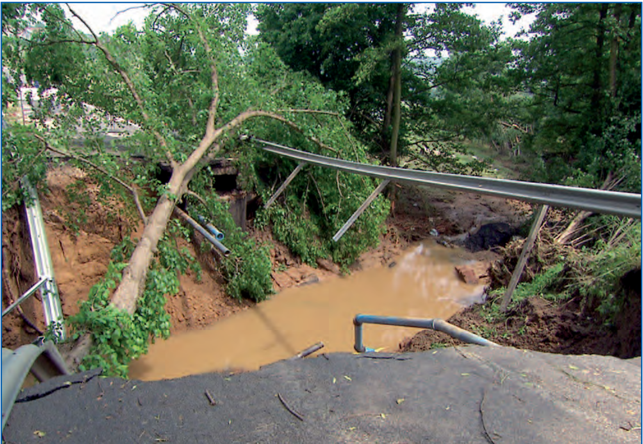
Brücke L79 zwischen Leimersdorf und Birresdorf, Starkregenereignis 2016
