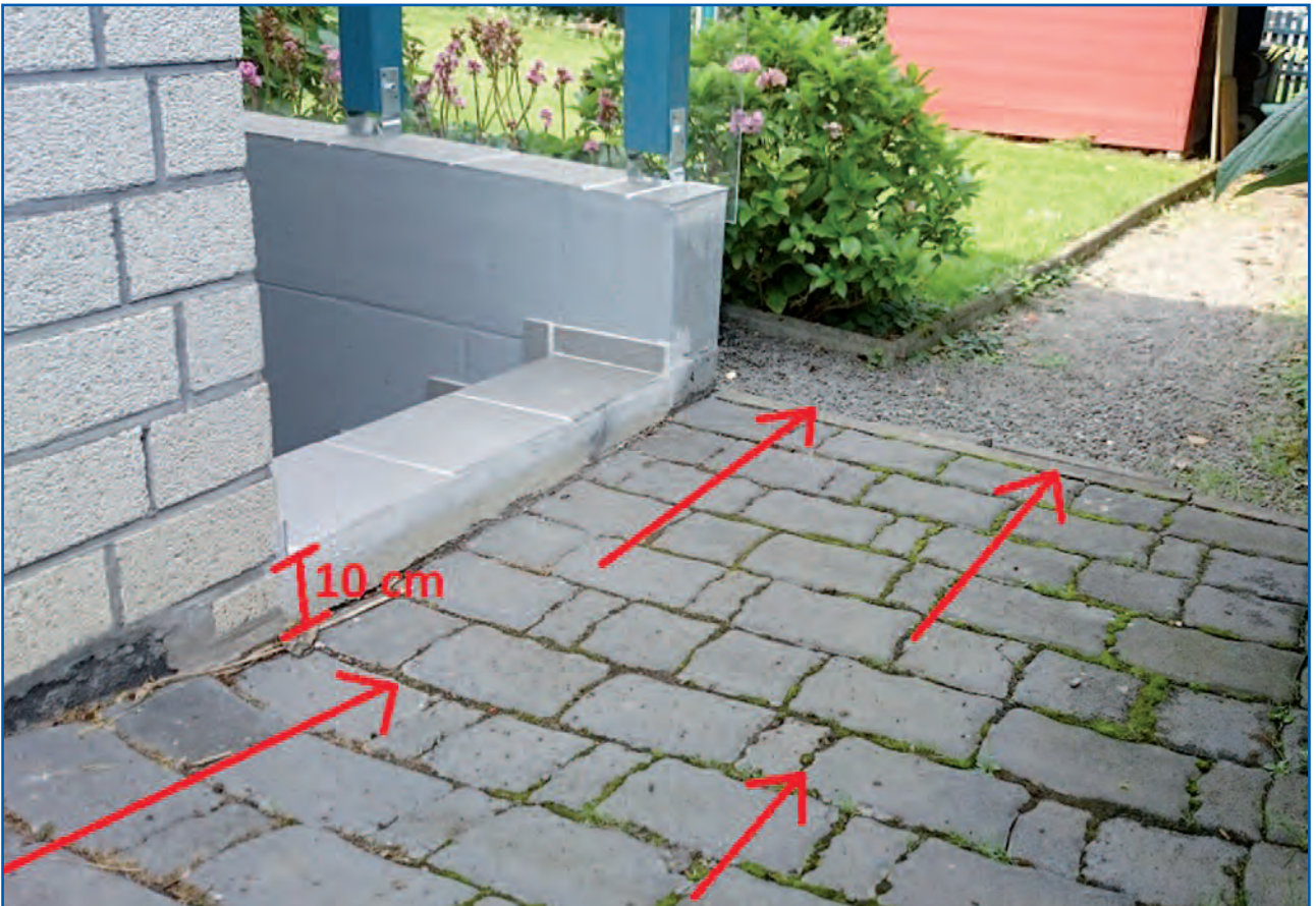
Nachträgliche Aufkantung vor Kellerabgang an einem Wohnhaus in Oeverich
