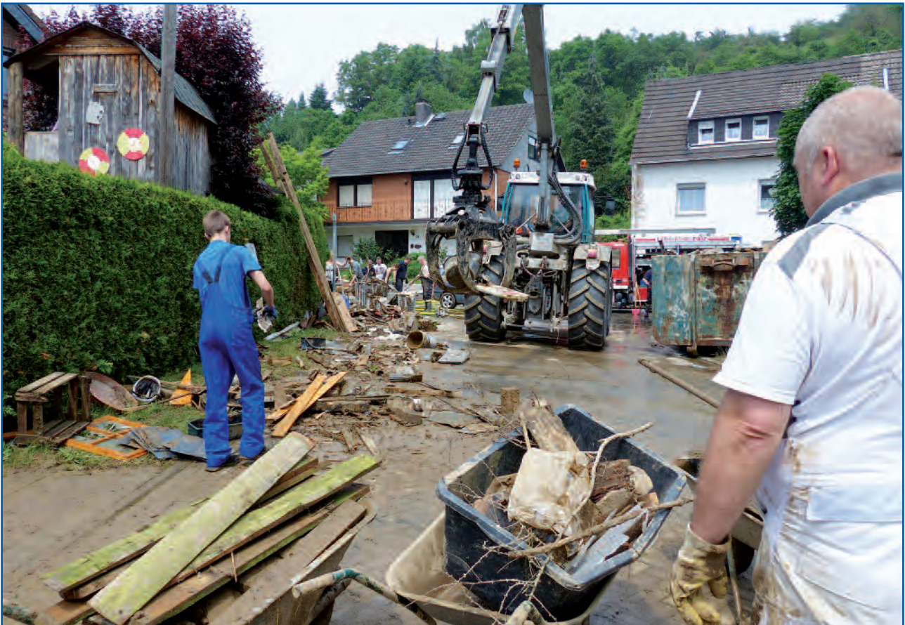
Aufräumarbeiten in Nierendorf nach Starkregenereignis 2016
