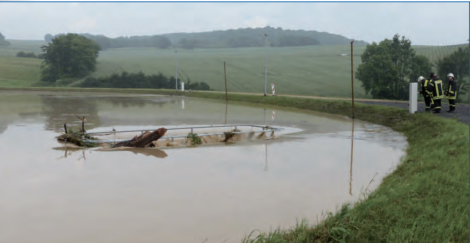
Verklauster Notüberlauf am Hochwasserrückhaltebecken in Nierendorf, Starkregenereignis 2016
