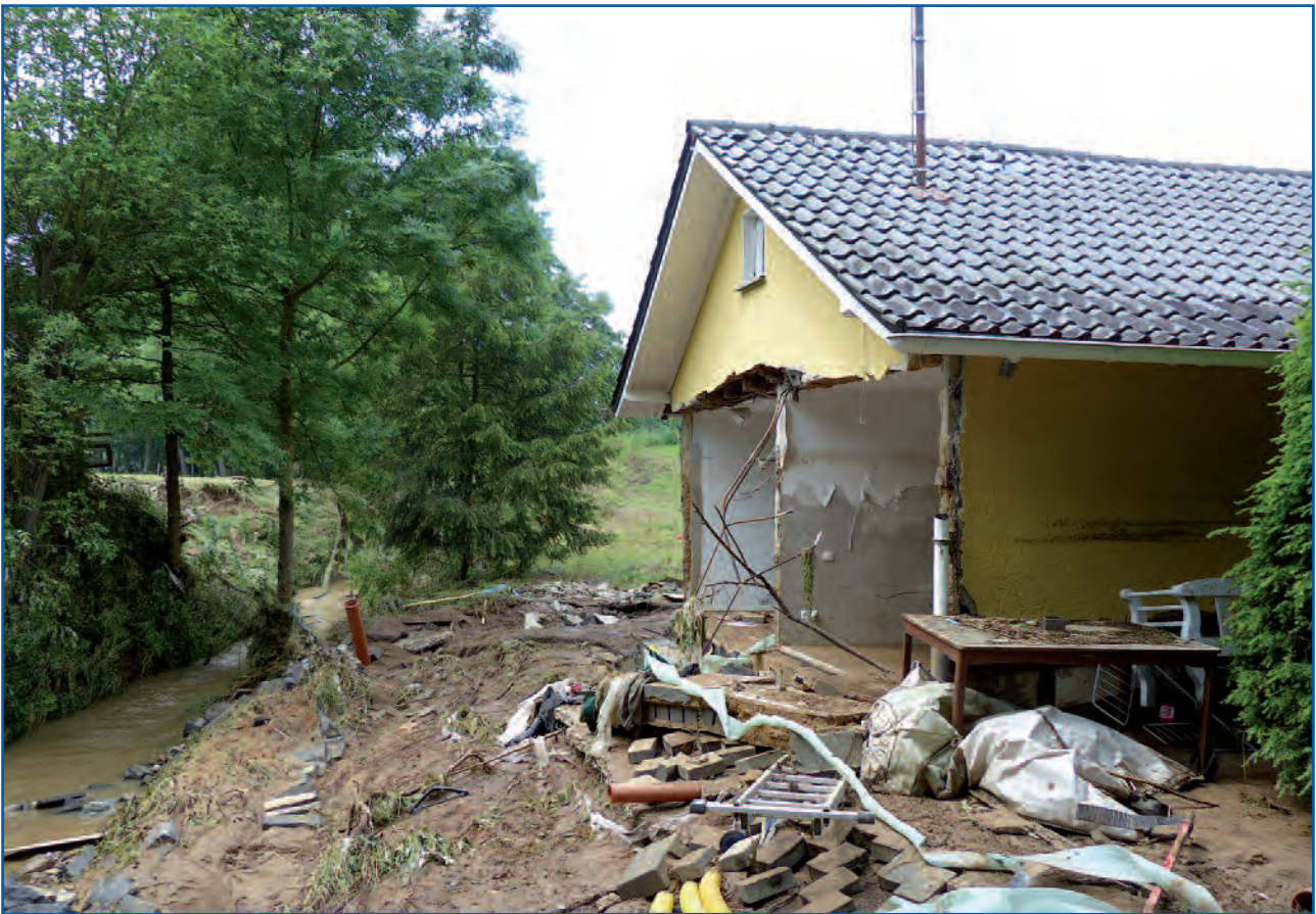
Zerstörtes Haus am Bartholomäusweg in Leimersdorf, Starkregenereignis 2016
