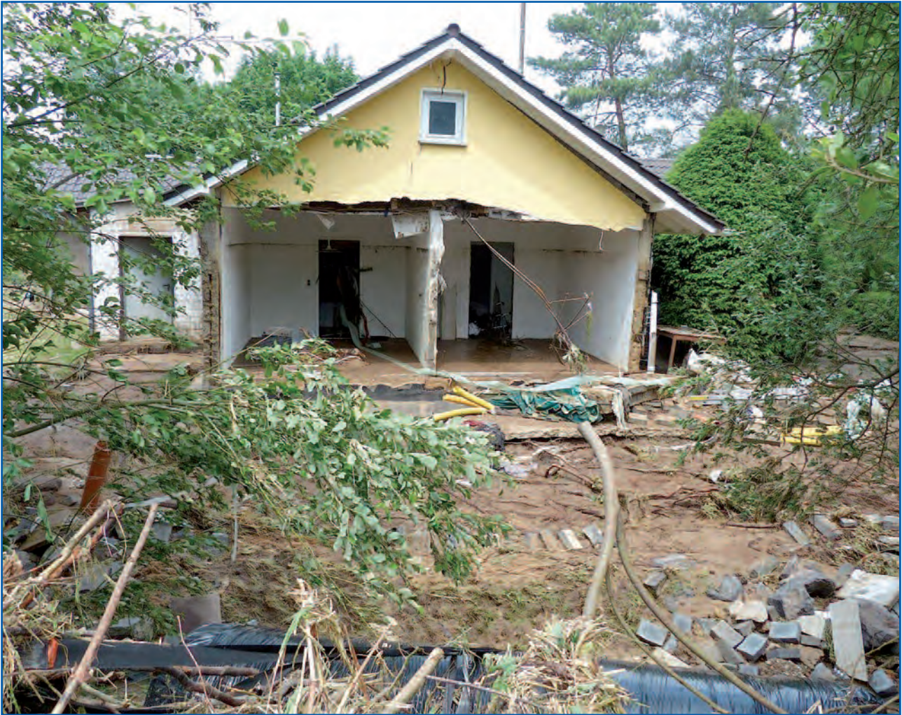
Zerstörtes Haus am Bartholomäusweg in Leimersdorf, Starkregenereignis 2016
