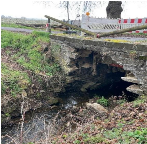
Abb. 27: Brückenbauwerk „Oberescher Weg“ nach dem Starkregenereignis 2021, Esch, eigene Aufnahme
