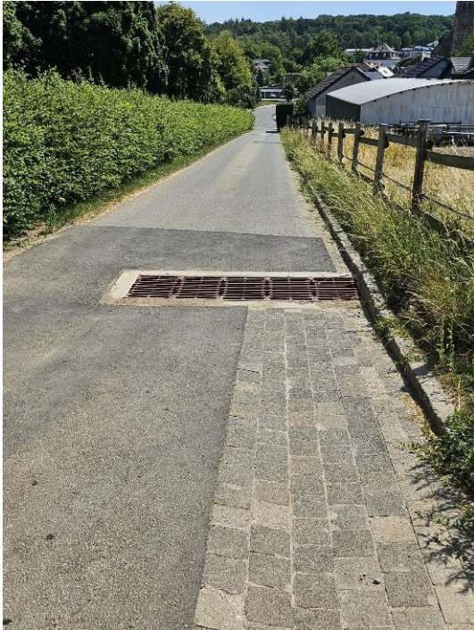
Abb. 6: Schlammfang am Friedhof, Holzweiler, eigene Aufnahme, 2025
