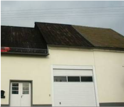
Zerstörung der Fassade durch ein unproportionales Hoftor
