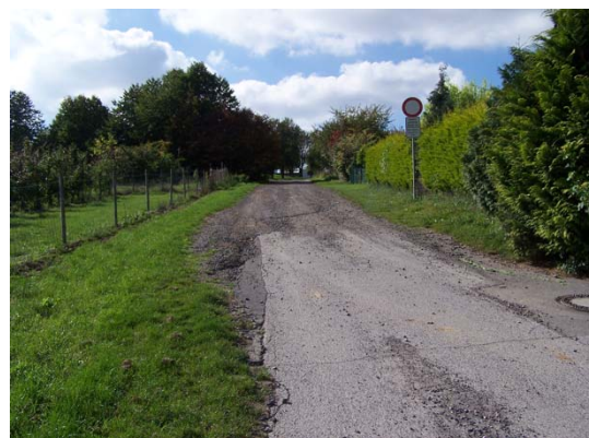
Bild 70 Zufahrt zum Sportplatz, Straßendecke in einem schlechten Zustand
