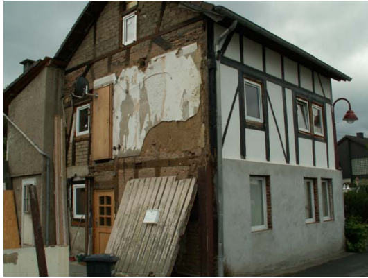
Bild 18 Rheinstraße 24, wurde zur Zeit der Aufnahme saniert, Kunststofffenster ohne Sprossen
