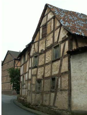
Bild 25 Schmittstraße 6, Fachwerkhaus aus dem 18. Jh., sehr stark beschädigt
