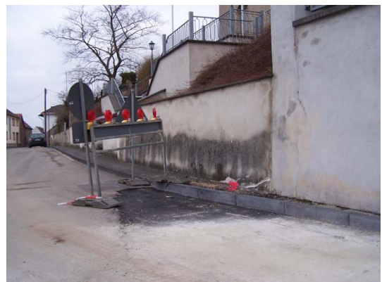
Bild 17 Mauer an der Kirche, Feuchtigkeit im Mauerwerk
