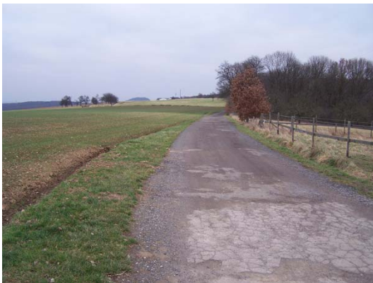
Bild 42 Fußweg zur Marienkapelle, Wege- decke in schlechtem Zustand
