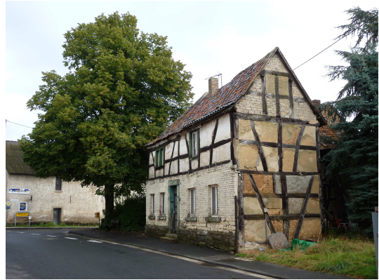
Bild 28 Graf-Otto-Straße 19, Fachwerkgebäude mit hohem Sanierungsaufwand, Schäden an allen Bauelementen, hat negativen Einfluss auf das Ortsbild
