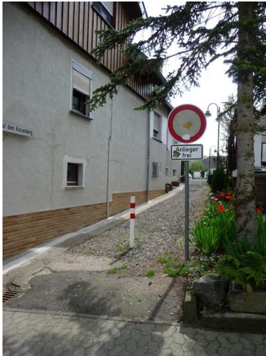
Bild 52 Auf dem Kutzenberg. Der Straßenbelag müsste erneuert werden. Der Pfosten stellt eine Gefahr für Rad-fahrende Kinder dar.
