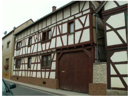
Bild 22 Gimmiger Straße 11, Fachwerkhaus, der Strukturputz passt nicht zum alten Fachwerk
