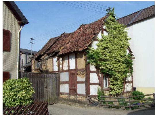
Bild 16 Bogenstraße 19. Das von Verfall bedrohte Fachwerkhaus wird nicht mehr bewohnt.
